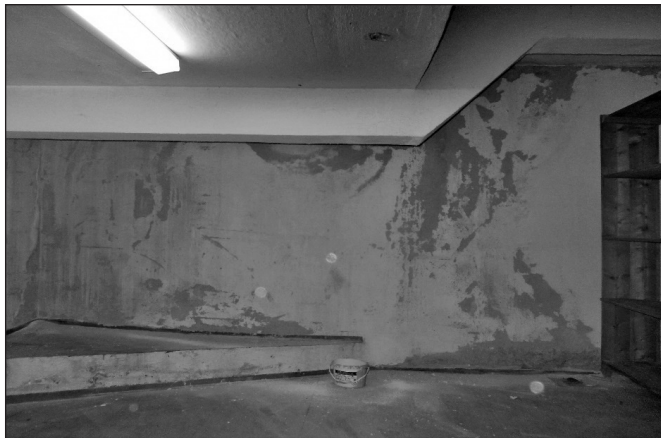
Prilog 2. Prostor depoa Istorijского arhiva u Vranju posle prodora vode i izmeštanja arhivske građe.
